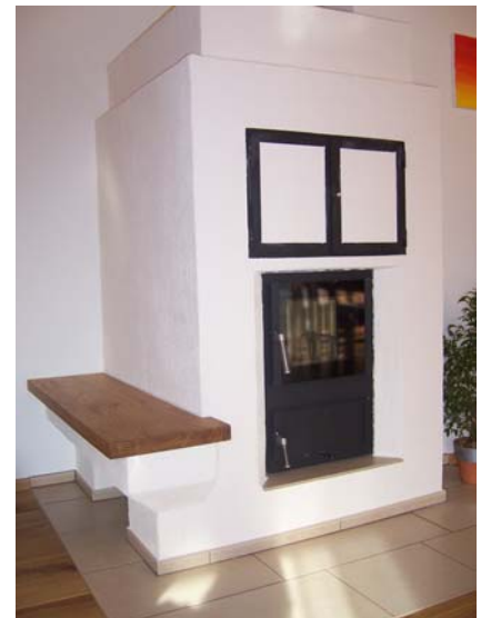
Einzige Nachheizquelle ist der POWALL Vario K Zentralheizungsofen, der im Wohnzimmer steht.
