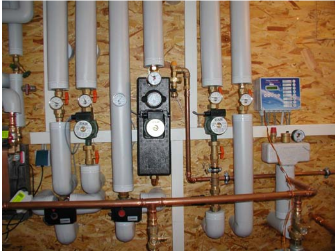
Die Technik: Hinter der Installationswand steht der SWISS-SOLAR-Pufferspeicher mit ca. 6.100 l Inhalt.
