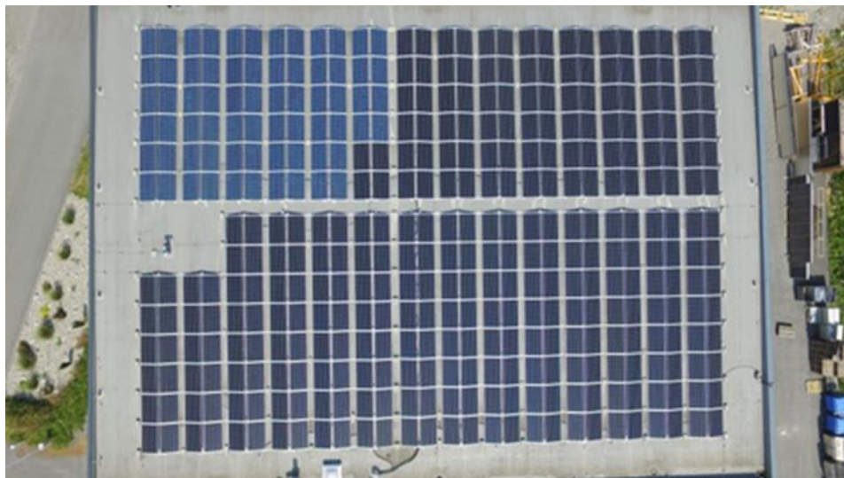
Blick aus der Vogelperspektive auf die PV-Anlage mit 120 kW Leistung. Foto: SST Solar
