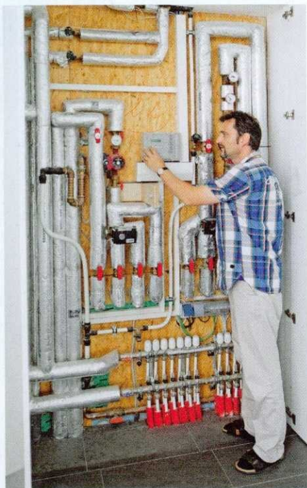
Schaltzentrale: Bert Kowalzik hat die Schranktür im Flur geöffnet, hinter der sich das Herz des beeindruckenden Heizsystems befindet.
