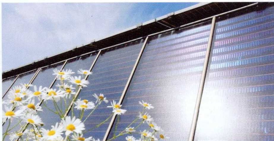
Überschuss: Die 60 Quadratmeter große Photovoltaikanlage produzierte im Jahr 2011 über 8200 kWh Strom, bei einem Eigenverbrauch von nur 7200 kWh.
