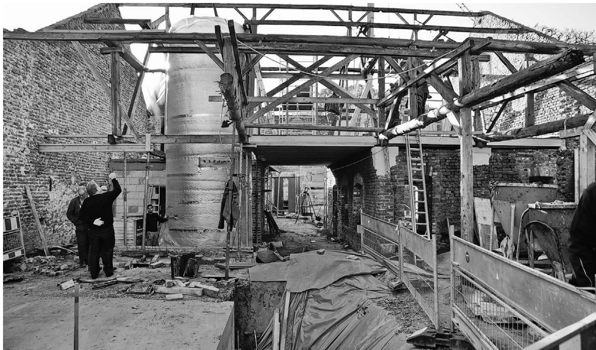
Gigantischer Warmwasserspeicher: 40 000 Liter fasst der Behälter, der im Zuge der Sanierung in den Vierkanthof „Wilde 16“ in Verlautenheide eingebaut worden ist. Aus dem alten Gut soll ein modernes Sonnenhaus werden. Foto: Andreas Herrmann
