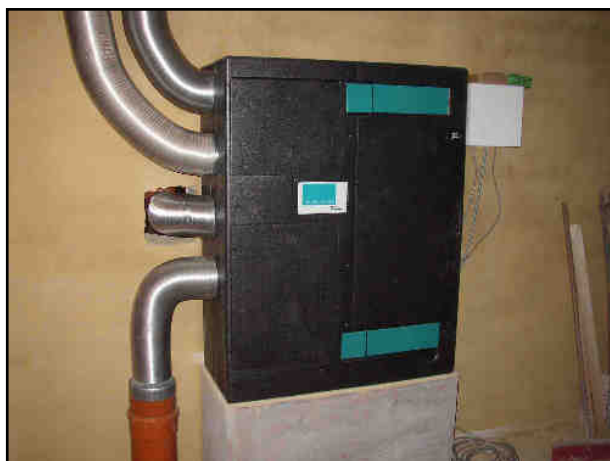
... bis zum Wärmerückgewinnungsgerät im Keller
