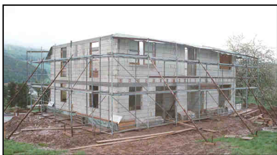
Der beheizte Teil des Hauses in der Rohbauphase: Ein viereckiger Kasten ohne jegliche Schnörkel
