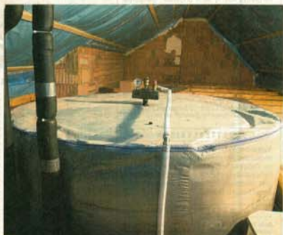
Der Wassertank fasst 9300 Liter. Er reicht vom Erdgeschoss bis unter das Dach. Am Ende eines ertragsreichen Sommers hat das durch die Sonnenkollektoren aufgeheizte Wasser bis zu 90 Grad. Es ist eine geistreiche architektonische Herausforderung, ein solches Fass in ein Haus zu integrieren.
