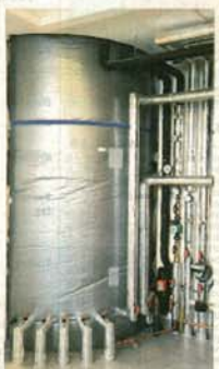
Der Wassertank fasst 9300 Liter. Er reicht vom Erdgeschoss bis unter das Dach. Am Ende eines ertragsreichen Sommers hat das durch die Sonnenkollektoren aufgeheizte Wasser bis zu 90 Grad. Es ist eine geistreiche architektonische Herausforderung, ein solches Fass in ein Haus zu integrieren.
