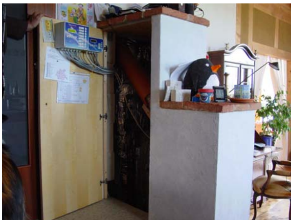
Schön versteckt: Steuerung und Pelletzuführung sind auf der Rückseite des Ofens zugänglich. Der Pufferspeicher steht zentral im Haus und reicht über zwei Etagen.
