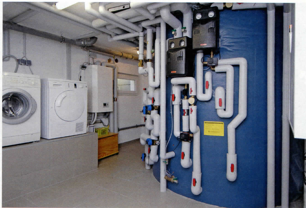
Der Wärmespeicher dominiert mit seinen 4.500 Liter Inhalt den Technikraum. Platz für Waschmaschine und Trockner auf ihrem rückenfreundlichen Sockel bleibt aber trotzdem.
