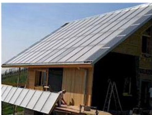
Solardach (Südseite) - Thermie + PV
